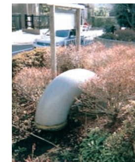
●地上部 換気孔
