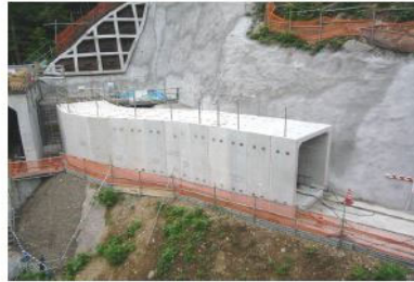
高速道路ジャンクション 排気管
