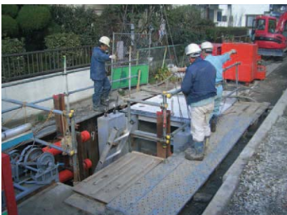
▲函体は発進立坑内に吊り下し、元押し設備で順次送り出します。
